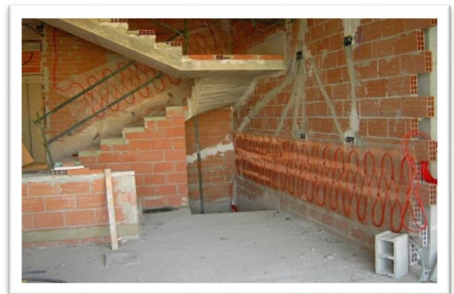
Instalación de pared radiante
